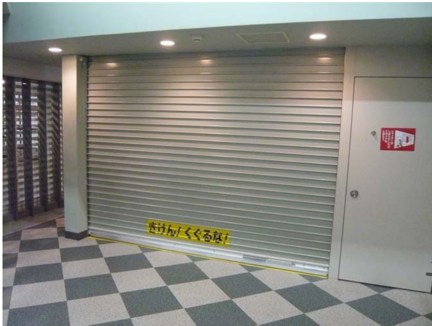
無線式避難時停止装置付き防火シャッター
