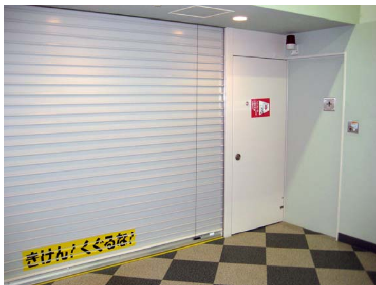
電池式避難時停止装置付き防火シャッター
