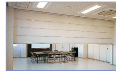
天井収納電動間仕切
