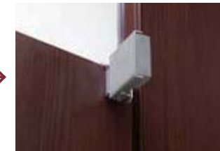
非常解戸当りの固定が解除された状態
